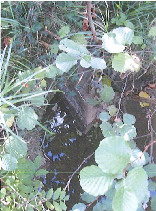
Auslauf Regenwasserkanal in den Klingbach
