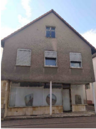
Abbildung 38: Schlechte äußere Bausubstanz mit Störwirkung (Holzgasse 4)
