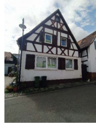
Abbildung 40: äußere Bausubstanz mit grundlegenden Mängeln im Gesamterscheinungsbild (Käsgasse 11)
